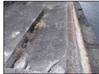
沈下 (塩浜地区)
