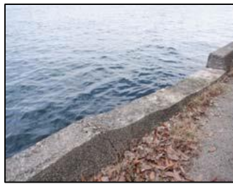
損傷 (石原地区)
