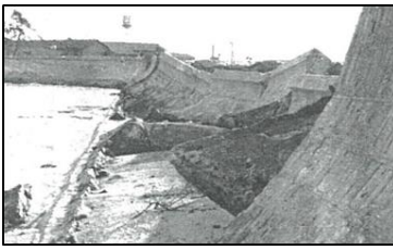
決壊した堤防
